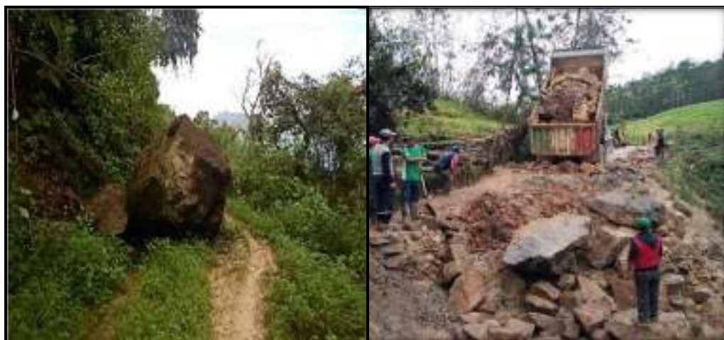
Foto 42 Ruta CA-1224 y ruta CA-100, obstrucción por caída de roca y deslizamiento de la plataforma de la vía.
