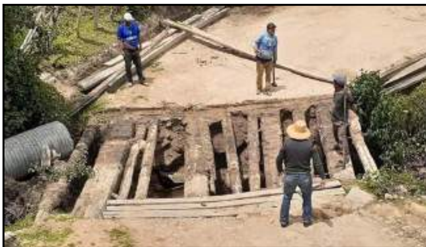
Foto 29: Sector Huatay, caserío La Quinua y sector Minis colocación de tablas de Puentes Carrozables- distrito de Unión Agua Blanca
