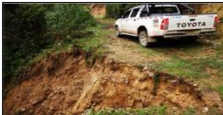
Foto 12: Ruta R0611023 a Pampa Cuyoc rotura de la superficie de cerro por escurrimiento pluvial y erosión que daña la plataforma de la vía.
