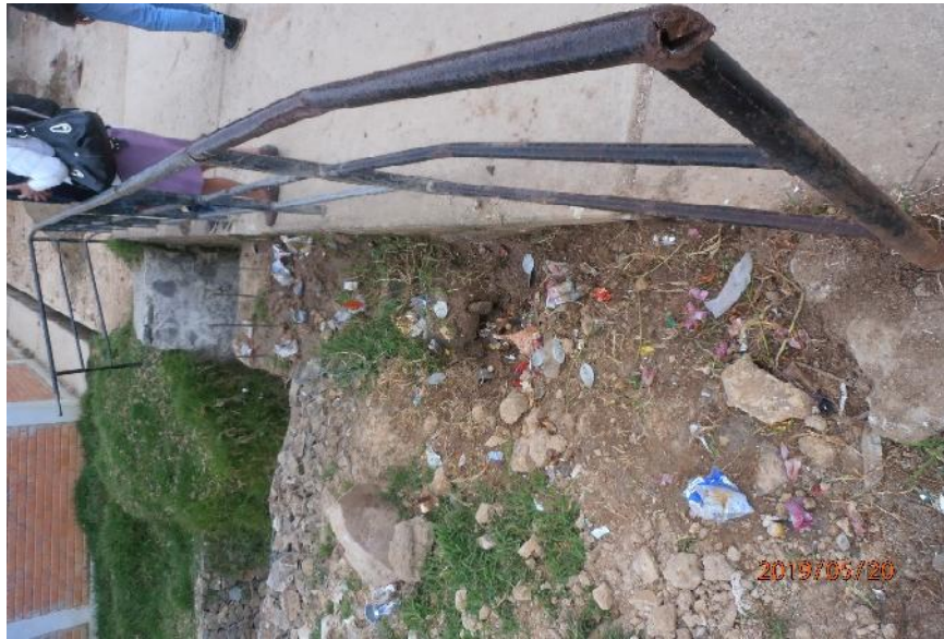
Figura 11 : Punto Crítico ubicado al costado del puente de acceso al colegio – Distrito de Llapa
