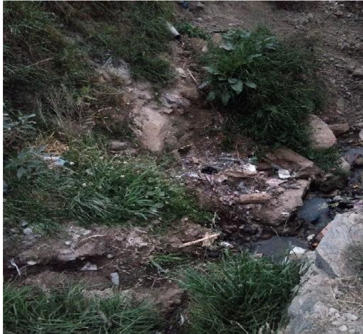
Figura 09: Punto crítico ubicado en la Prolongación 28 de Julio – Distrito San Miguel
