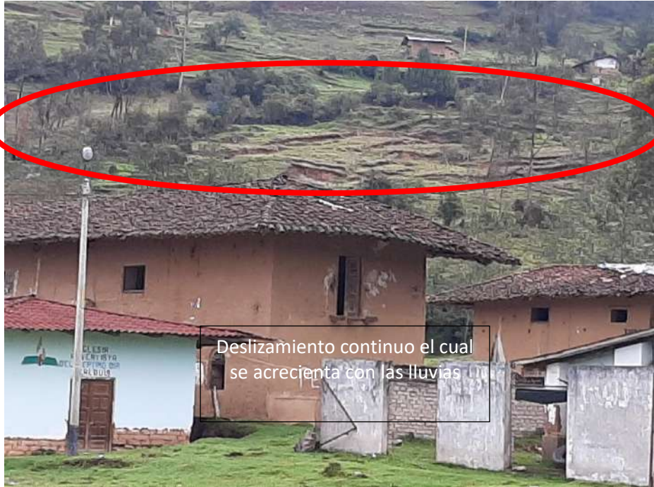
Imagen 6. Deslizamientos continuos que se van desarrollando casi en el centro de la ciudad.
