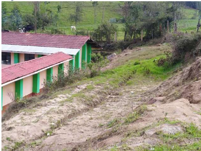
Imagen 7. Deslizamientos continuos que se van desarrollando casi en el centro de la ciudad.
